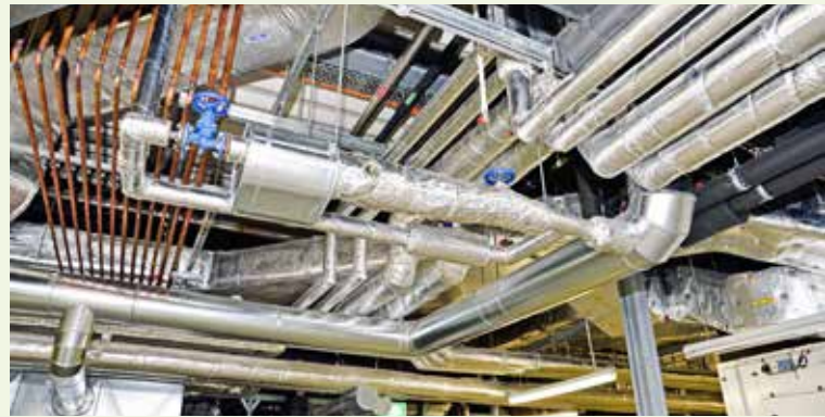
Filter, Lüftungskanäle und Messeinrichtungen sorgen am UKJ für die Luftqualität.
