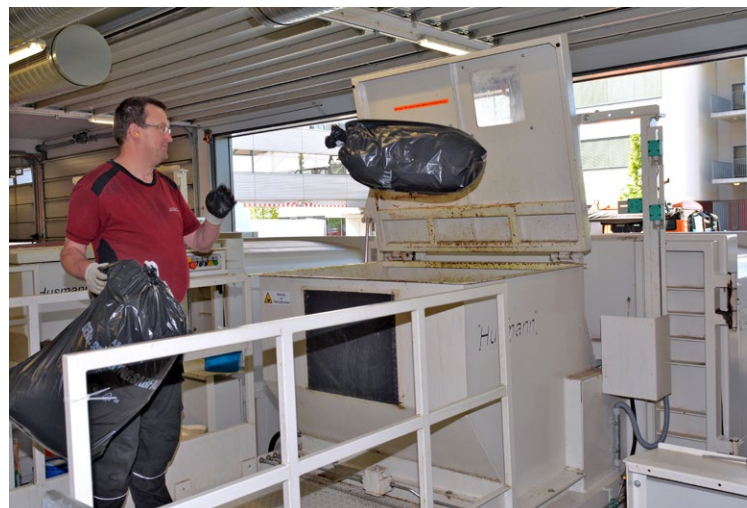
Neben einer Kühlzelle sowie verschiedenen Gefahrstoff- und Glascontainern befinden sich unter anderem auch sechs Abfallpressen im Wertstoffhof.
