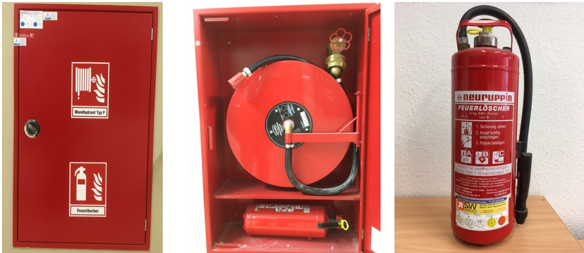
Abbildung 5 - links: Wandhydrant von außen und innen, rechts: Feuerlöscher
